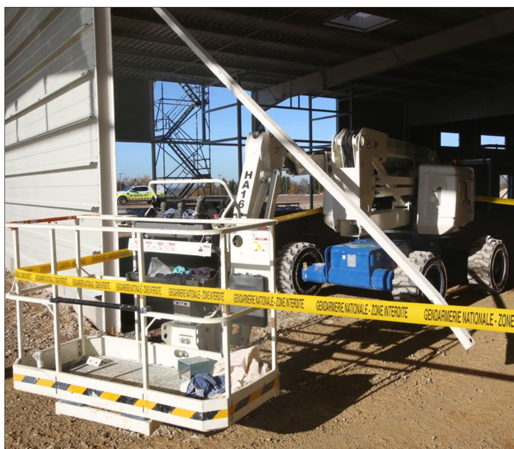
Mercredi dernier, un ouvrier a été retrouvé coincé entre sa nacelle et une poutrelle métallique sur un chantier de Phalsbourg. Son état était jugé désespéré. Photo Laurent MAMI
